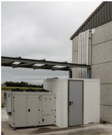
Koelinstallatie op propaan
